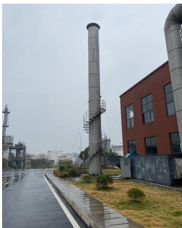
原料库、危险废物暂存间废气排放口
