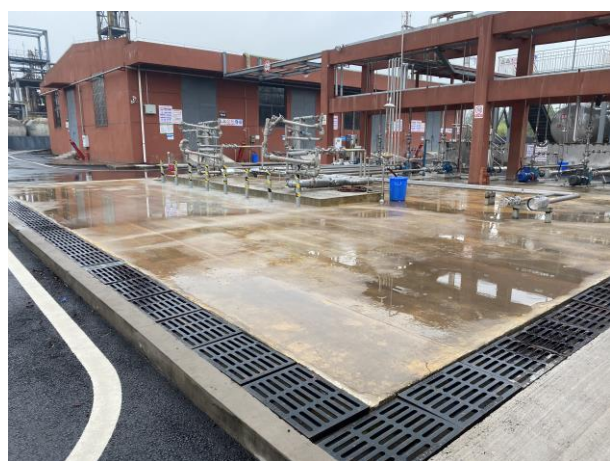
储罐装卸区设置截流沟
