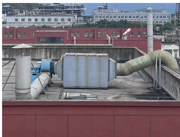
杀虫、杀菌剂液体车间换风废气处理设施
