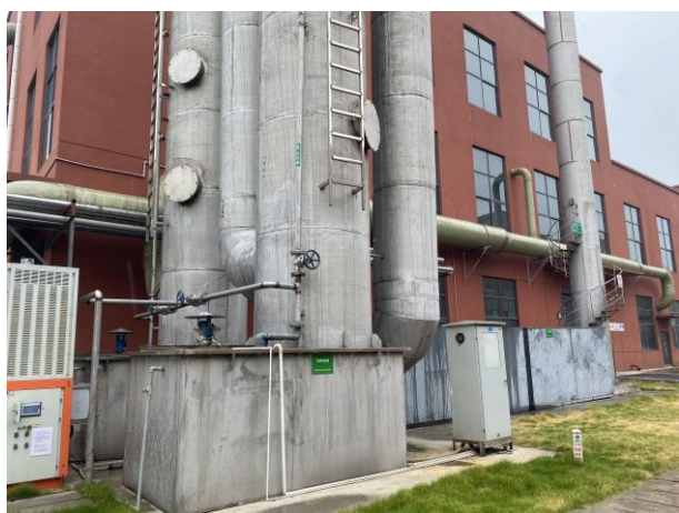
除草剂液体车间生产线废气处理设施
