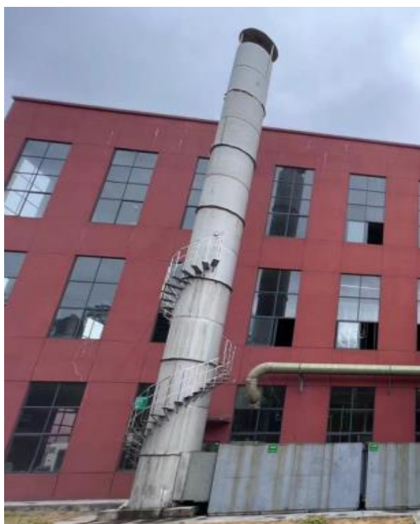
固体车间生产线、污水处理站废气排放口
