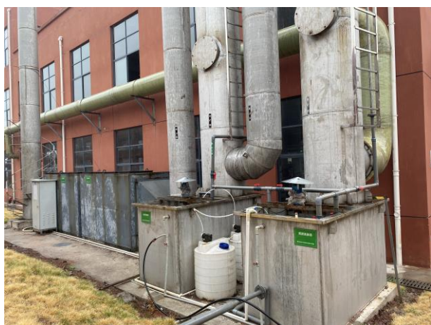
杀虫、杀菌剂液体车间生产线废气处理设施
