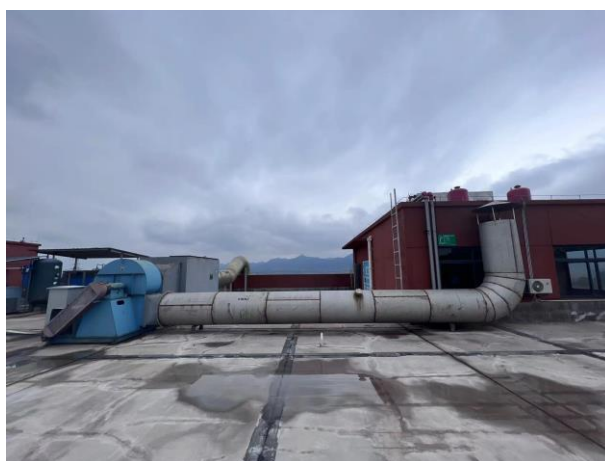
固体车间换风废气处理设施
