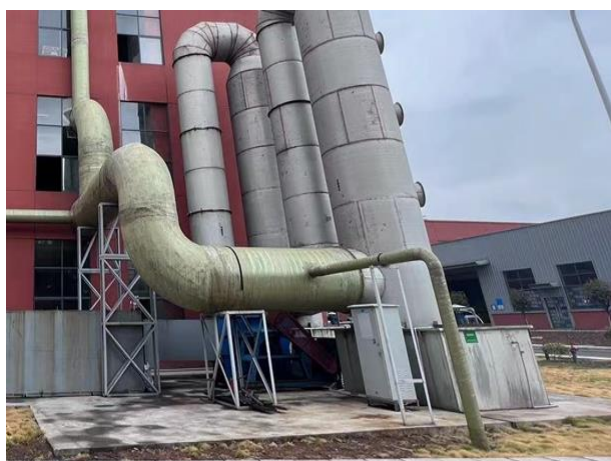
固体车间生产线、污水处理站废气处理设施
