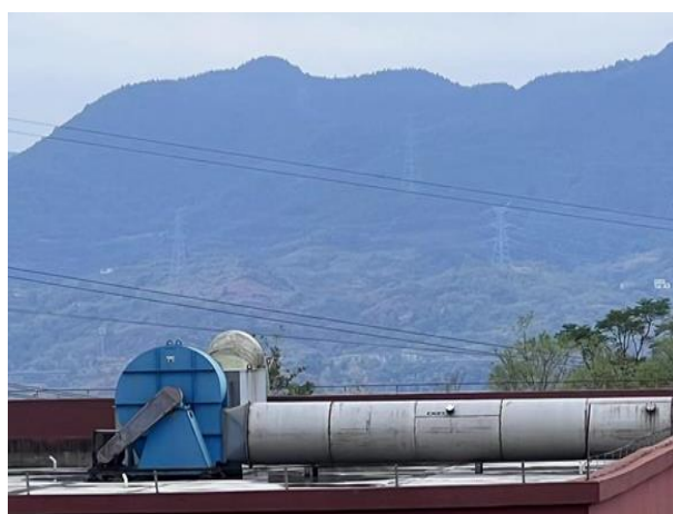
除草剂液体车间换风废气处理设施
