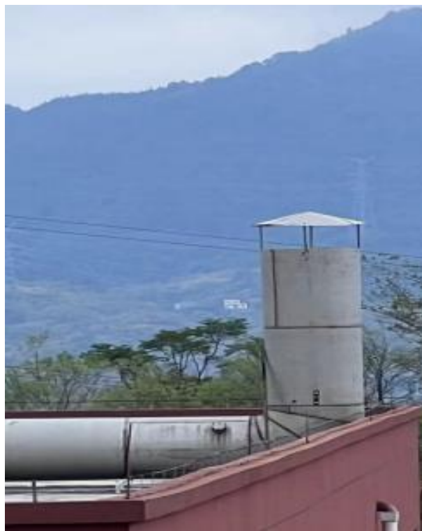
除草剂液体车间换风废气排放口
