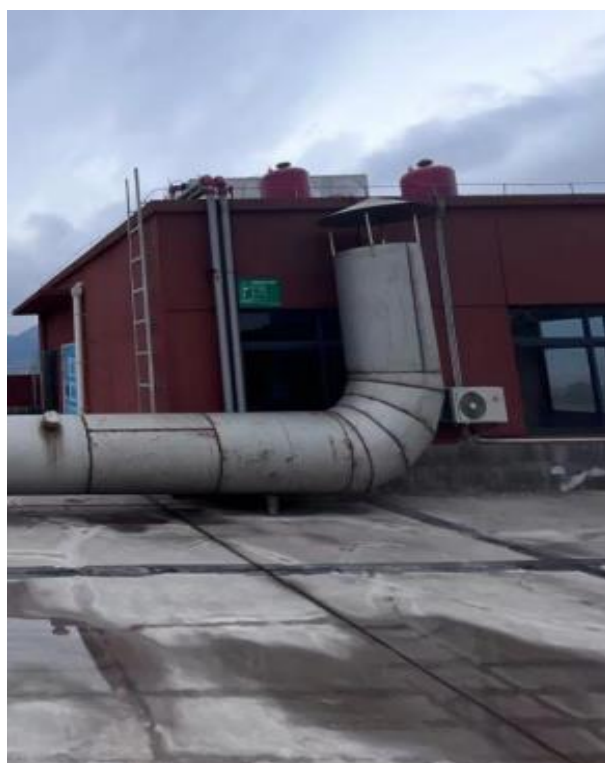
固体车间换风废气排放口
