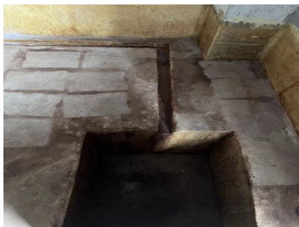
甲类库房设导流沟、收集井
