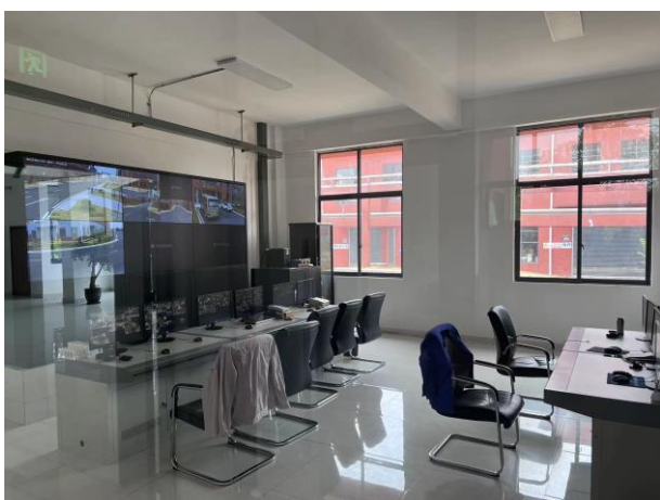
控制室连接视频监控系统
